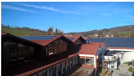
PV Anlage beim Kultur- und Sportzentrum
